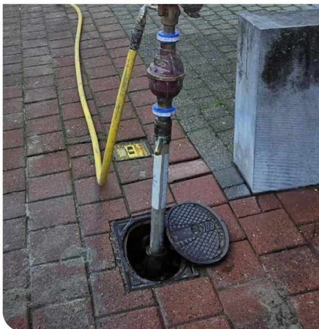
Figuur 6: hydrant met standpijp
