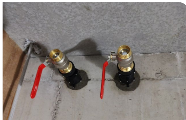
Figuur 21: bolkraan onder plafond in kelder
