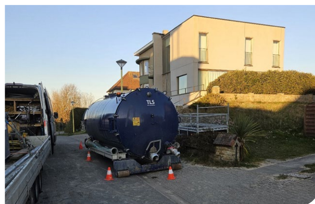
Figuur 10: tank voor afvoer boorslib
