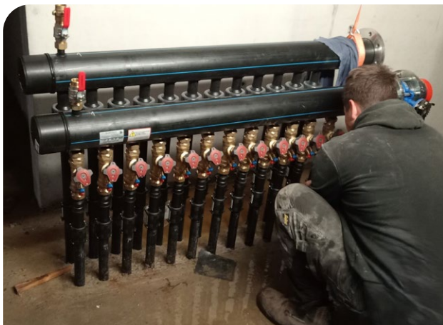
Figuur 18: collectorbalk in de technische ruimte
