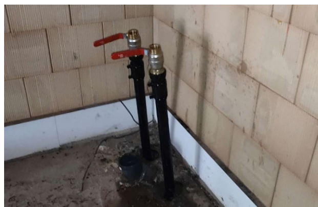
Figuur 22: bolkraan boven wachtbuis in technische ruimte
